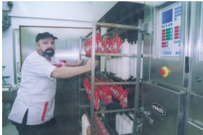
Die Airmaster-Anlagen sind komplett programmiert. Heinz Wingen muss lediglich die Räucherware in die Kammer hängen und das dazu passende Programm wählen.
